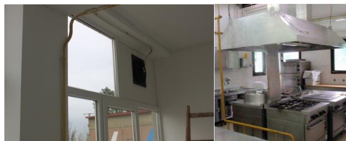
Odsisni ventilator i napa u kuhinji
