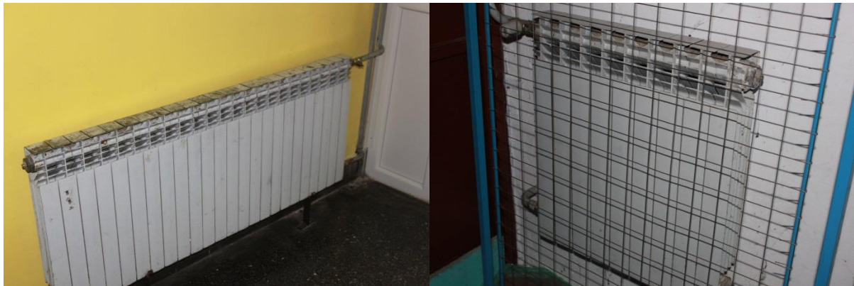
Ogrjevna tijela u sustavu grijanja Osnovne škole
