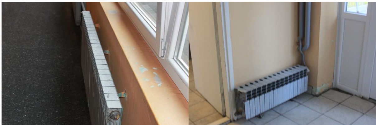
Ogrjevna tijela u sustavu grijanja Osnovne škole
