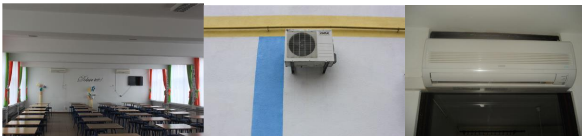
Unutarnja i vanjska jedinica split sustava hlađenja
