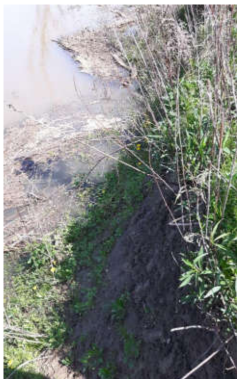
Slika 136. Erodirana obala na lokaciji
