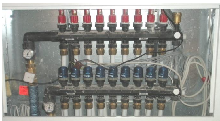
Slika. Razvodni ormar podnog grijanja
